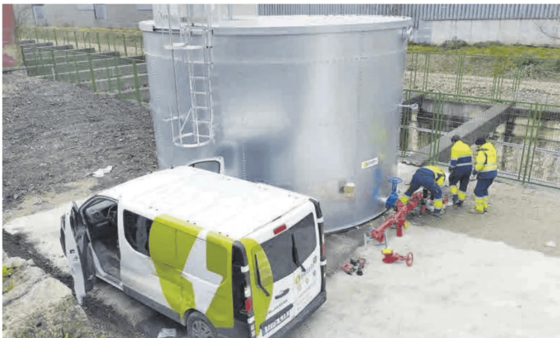
Uno de los depósitos de agua, instalado junto a la rampa de acceso al tramo soterrado, a la altura de la calle José Álvarez Valdés.
